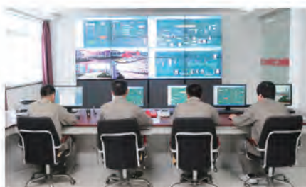
集团公司-企划部-何磊：尖端的DCS操控室
